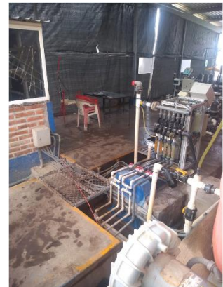
FUG 7.- Cabezal de riego.
